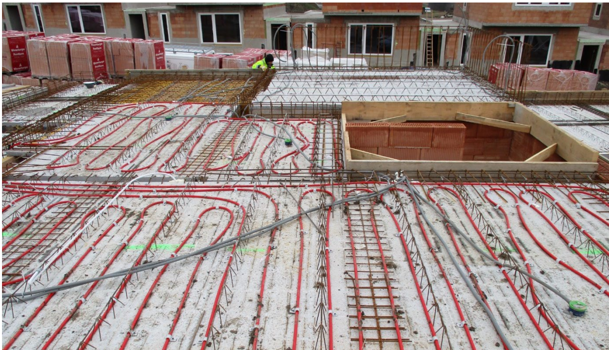
Abb. 3: Auf den Elementdecken verlegte Rohrleitungen der thermischen Bauteilaktivierung (rot) im Bereich der Reihenhäuser
