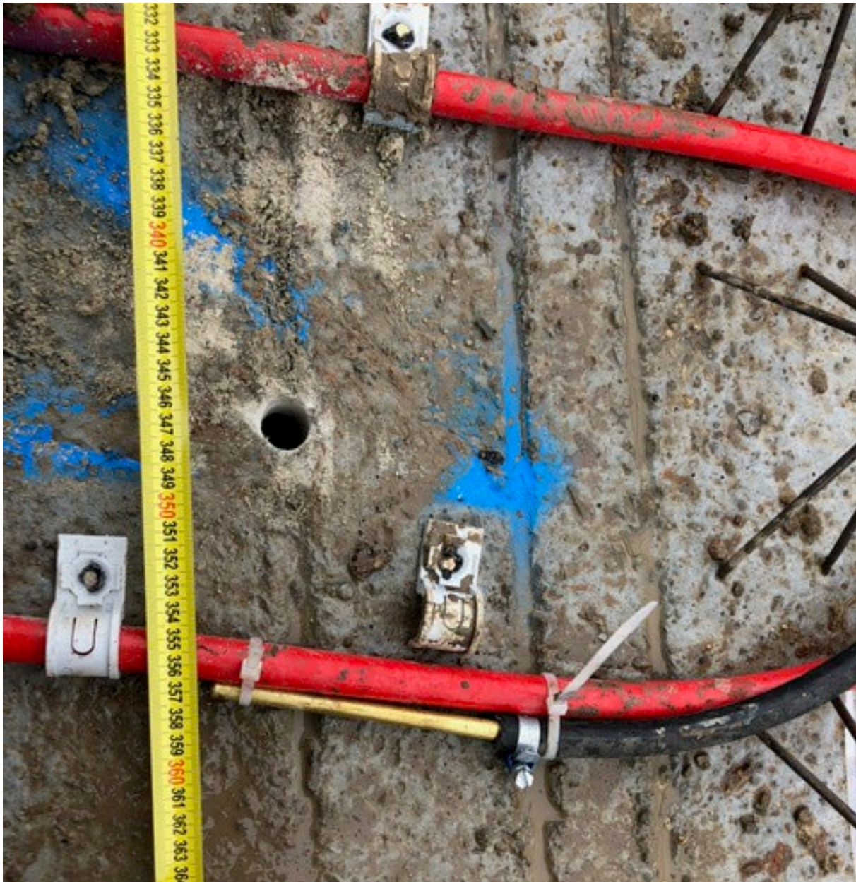
Abb. 55: Reihenhaus RH_M: Vermessung der genauen Position des in der Metallhülse befindlichen Temperatursensors für die Bestimmung der Temperatur des Heizmittels.
