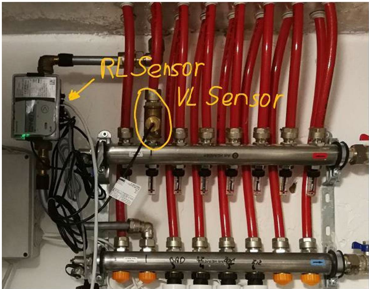
Abb. 54: Bild des Verteilers mit eingebautem Wärmemengenzähler in Reihenhause RH_M
