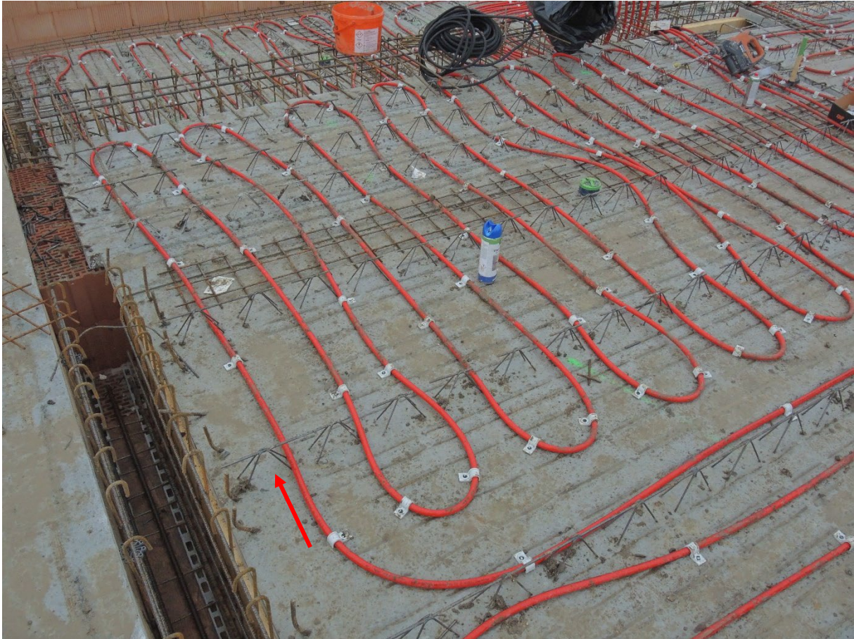
Abb. 56: Mäanderförmig verlegtes Register des Heizkreises 6 in der Decke der Wohnküche von Reihenhaus RH_M
