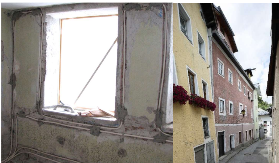
Abb. 18 Projekt „Sanierung Altstadtthaus Hallein“ Anbringung von Kupferrohren an der Wandinnenseite und um die Fenster sowie das Haus von außen @Habersatter Lindner
