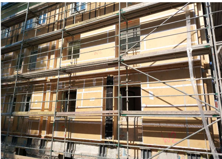
Abb. 14 Projekt „Wohnen findet statt“ Anbringung der vorgefertigten Fassadenelemente mit Dämmung © FH Salzburg
